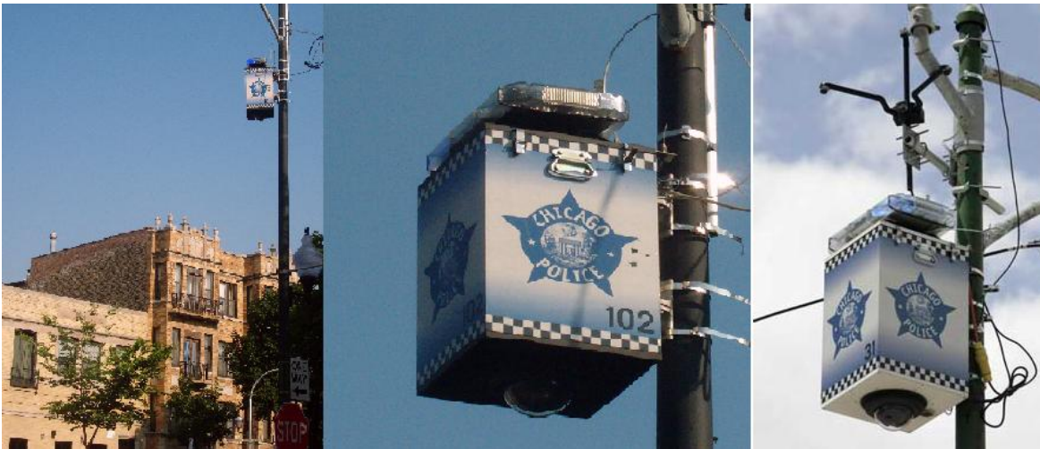
Rys. 7.3. Kamery miejskiego systemu CCTV (dwa pierwsze zdjęcia) i zestaw SENTRI zamontowane na ulicy w Chicago 135
