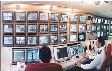
Rys. 7.2. Wnętrze centrum odbiorczego. 124
