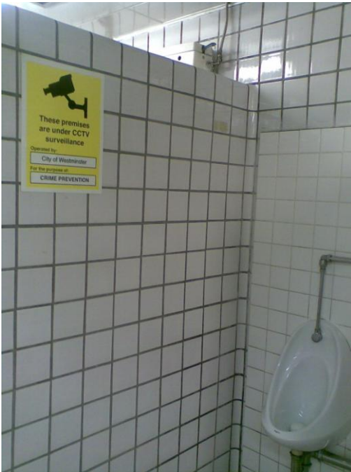
Rys. 7.25. System CCTV w publicznej toalecie w londyńskim metrze. 196
